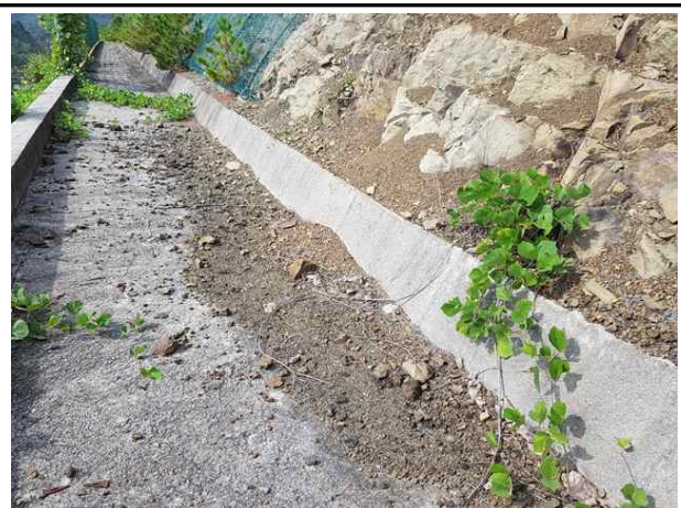
소단배수로 토사 및 낙석적치
